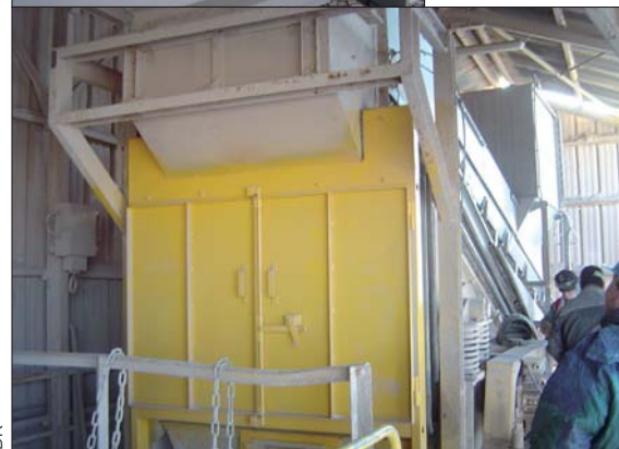
Portes d'accès indépendantes du crible
